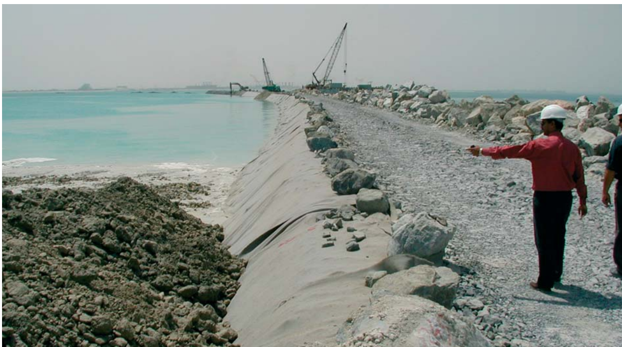
Zdroj: Palm Island, Dubai. Instalace Fibertexu F-650M. Geotextilie Fibertex bude kompletně zasypána štěrčkem a pískem.
