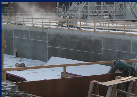
Станция очистки сточных вод, Канада
