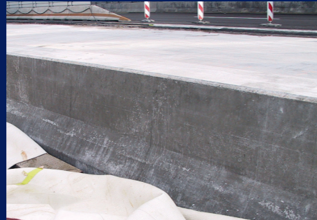
Autoværn, Zürich, Schweiz
