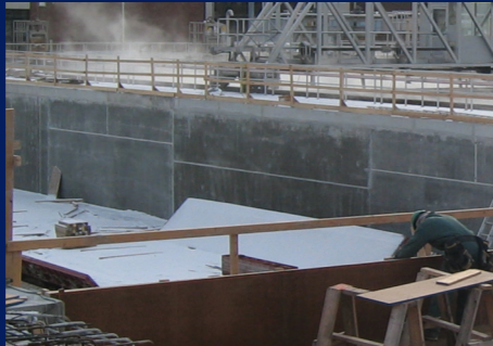
Čistírna odpadních vod, Kanada
