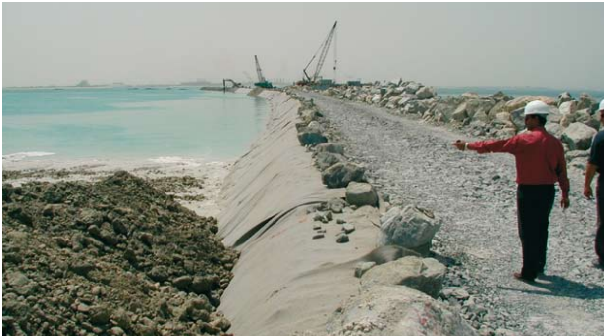
Fuente: Isla Palmera, Dubai. Colocación de Geotextil Fibertex F-650M. El geotextil se cubrirá de gravilla y arena.
