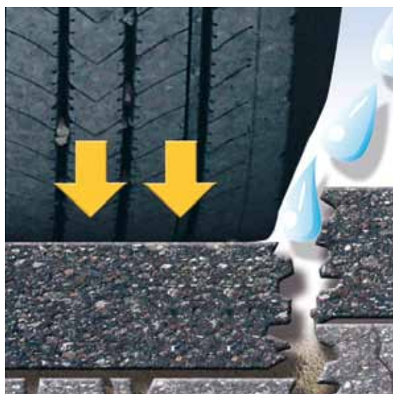
Obr. 2. Bez přítomnosti vozkových textilií se trhliny šíří do nového asfaltového koberce a povrchová voda pronikne do vrstvy starého asfaltu. Tím se urychlí deformace celé silniční konstrukce.
